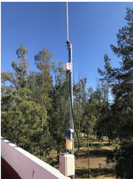
Fig. 6. Antena PROCOM CXL900-3LW, Fuente: Fotografía propia, 2020.
