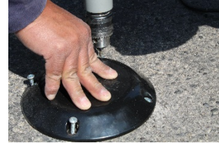
Fig. 14. Instalación de sensor en calzada del IMT. Fuente: propia.
