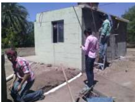
Figura 8. Conexión de tubería al tanque.
