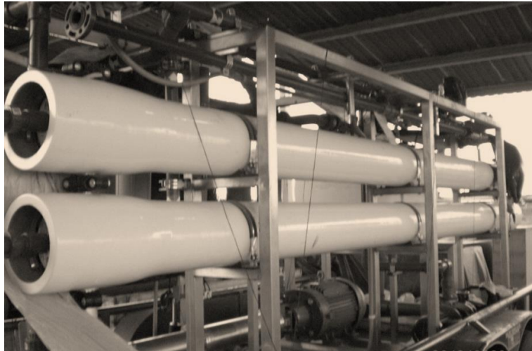
Figura 3. Planta piloto de Osmosis Inversa.
