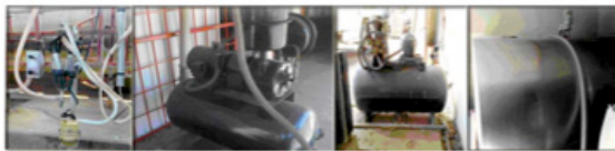
Manual de mantenimiento para máquinas y equipos que intervienen en el Proceso de Obtención y Tratado de Leche de Establo los Moreno.
